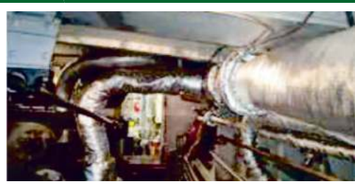
Tuberías de escape
